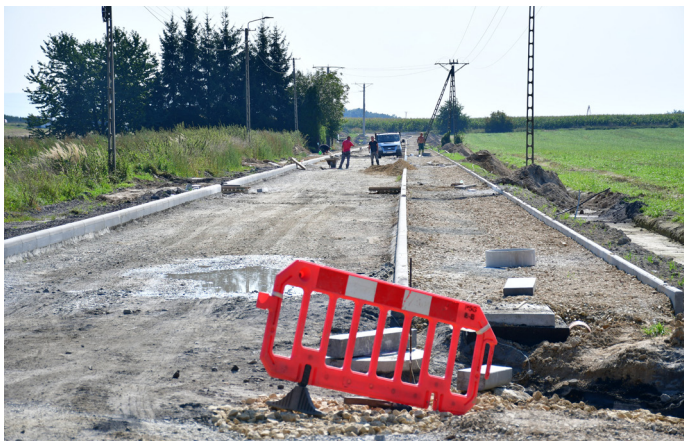
Na Kolonii Brzozowej powstaje nowa droga, pomiędzy ulicami Źródlaną i Spokojną (Fot. UG)
